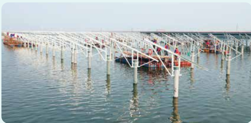
滨州沾化2GW渔光互补光伏发电项目
